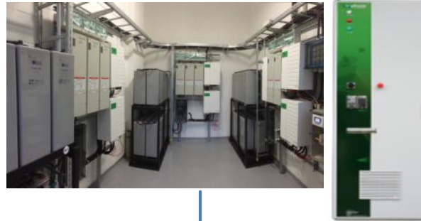
Speicher (Blei Säure 150 kWh)
